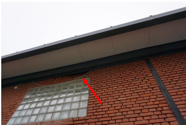
Abb. 11: südliche Fassade mit eingedrückter Stelle im Dachbereich (ISR 2023).
