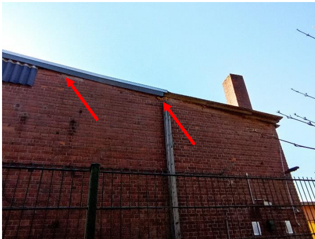
Abb. 9: nördliche Fassade der Lagerhalle mit Metallverkleidung und Löchern (ISR 2023).
