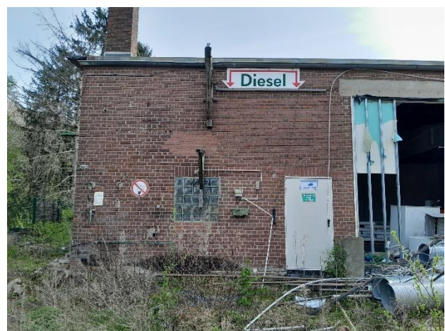
Abb. 6: offene Lagerhalle, Fassade mit Ritzen und Löchern (ISR 2023).
